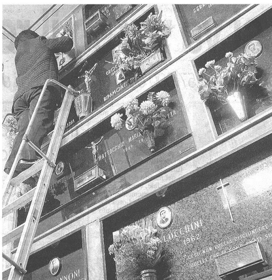
Ancora infiltrazioni nei loculi del cimitero. I parenti chiedono un intervento risolutore (foto Billa)
