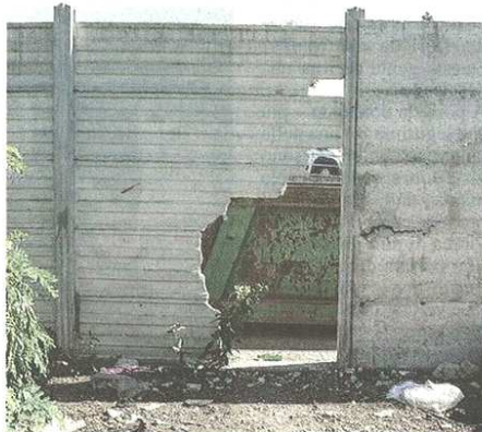
Il varco nel muro che permette ai malintenzionati di entrare nella piattaforma ecologica di via Turati (foto Blitz)
