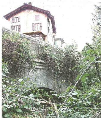
I ponti di Cairate e di Cuasso al Monte sono fra le criticità segnalate dalla Provincia all'Incontro di Milano
