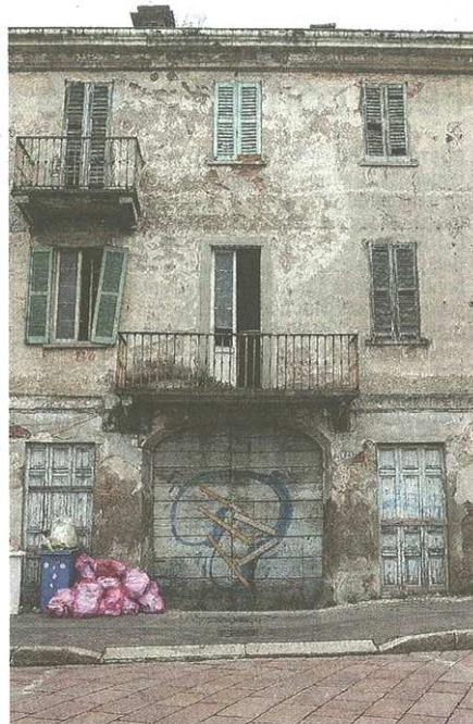
Uno degli edifici di via Matteotti in pessime condizioni
