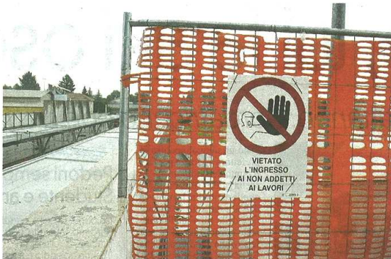
Il cantiere per la sistemazione della stazione permetterà di creare spazi per le bici
