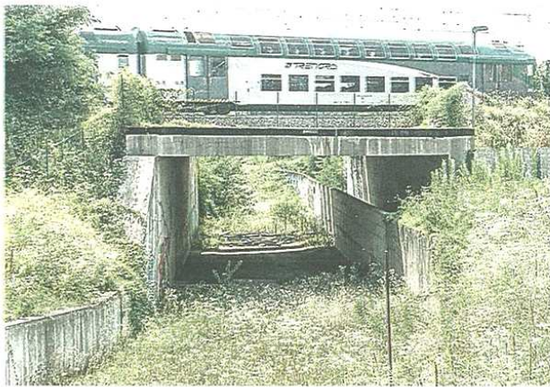
Il sottopasso incompleto di via Morelli è invaso dalle erbacce
