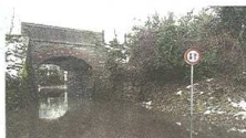
In via Morelli le piogge abbondanti dei giorni scorsi hanno causato danni notevoli alla circolazione come hanno evidenziato mercoledì i Verdi di Busto Arsizio criticando la situazione.
