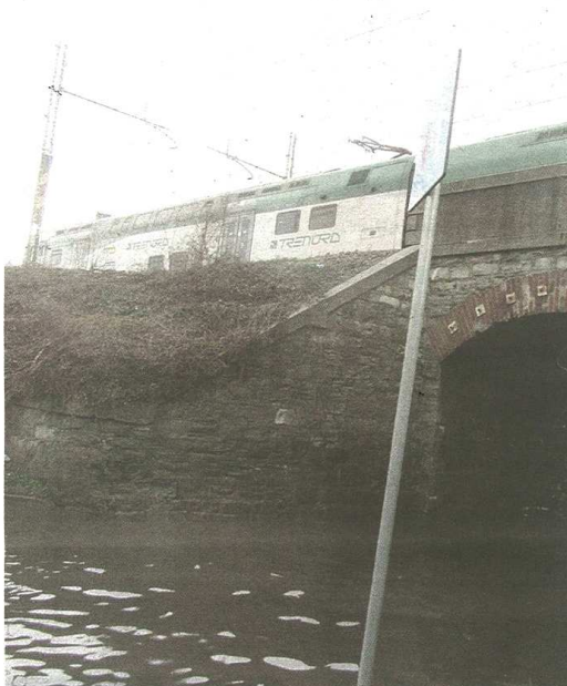
In ponticello di via Morelli sovrasta la strada allagata a causa delle piogge insistenti della settimana scorsa. Ora si preparano nuove strategie per una migliore viabilità
