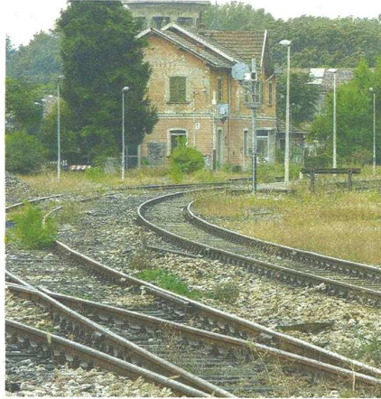
L'edificio della vecchia stazione resta per il momento ancora dismesso. Le giunte che si sono susseguite negli ultimi anni non hanno firmato l'acquisizione (Blitz)
