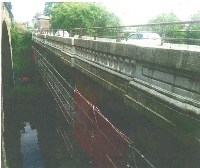
Costruito nel 1913, il ponte di via Piave necessita di opere di consolidamento (Blitz)
