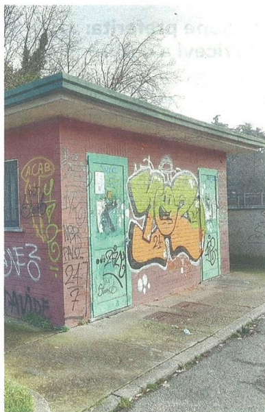
I bagni della piazza del Mercato sono in pessime condizioni: ricoperti da scritte all'esterno, sono praticamente inutilizzati a causa del degrado interno
